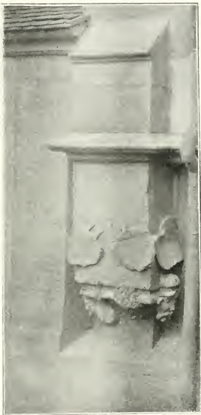
Obr. 30. Chrudim. Fragment opěrného pilíře.
